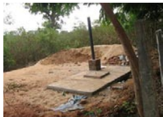
· Afgedichte sceptic-tank met ontluftpip
